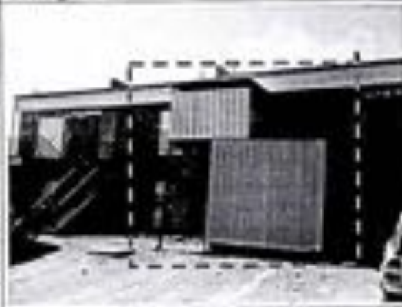
Fotografía N° 4: Ampliación irregular bloque ceste detalle 2.
